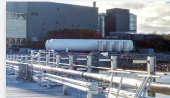
1,000 m 3 Mini LNG Terminal
