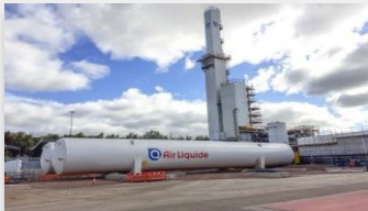
300 KL and 500 KL tanks
